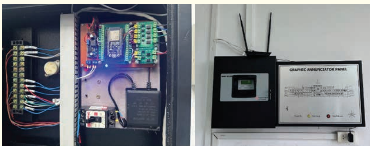
รูปภาพที่ 19 แสดงตู้ควบคุมระบบแจ้งเตือนเหตุเพลิงไหม้ และอุปกรณ์ที่ Upgrade ของ อาคาร บก.อร.
