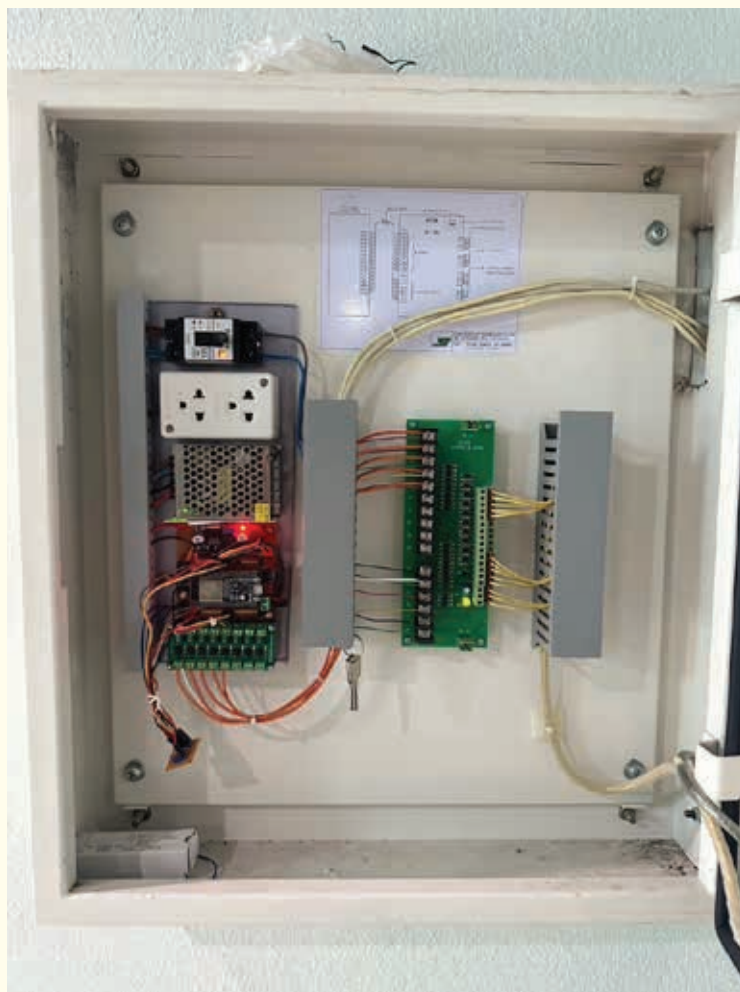
รูปภาพที่ 18 แสดงภายในตู้ควบคุมระบบแจ้งเตือน เหตุเพลิงไหม้ อาคาร บก.อรม.อร. หลังจากติดตั้งอุปกรณ์ Upgrade แล้ว
